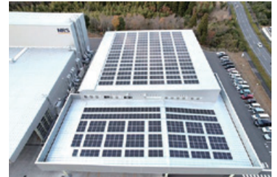
安装在土气流通中心的光伏面板
