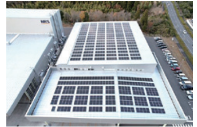
安装在土气流通中心的光伏面板
