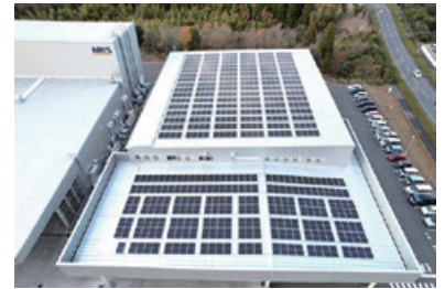
土気流通センターに設置した太陽光パネル
